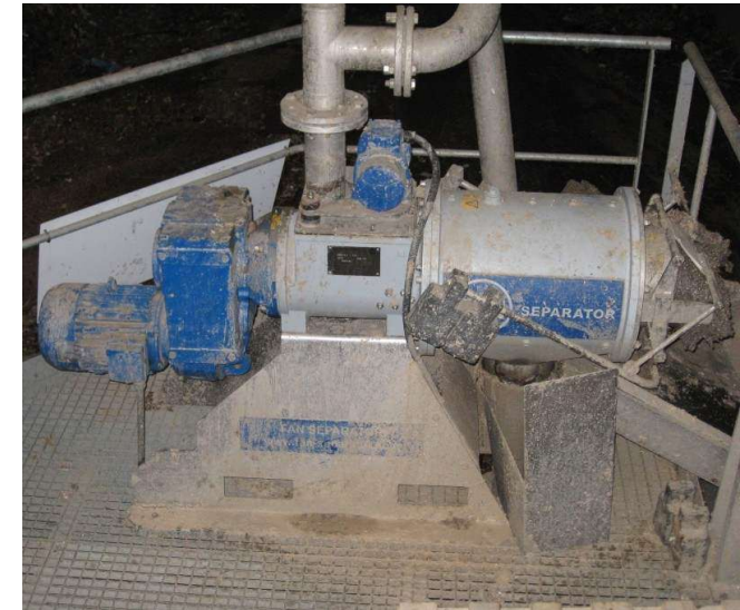
• Compacteur Fan separator 2 (T2C)
