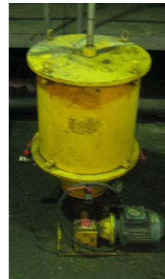
• Centrale de lubrification graisse
